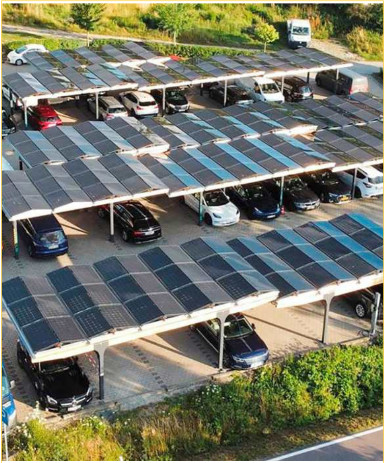
Abb. 78: Parkplatz mit Solardach in Osterfeldt, Sachsen-Anhalt Quelle: sopago
